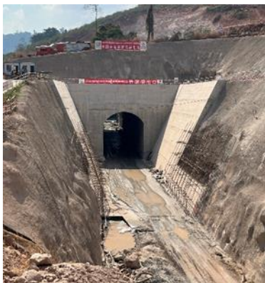
迂回トンネル
