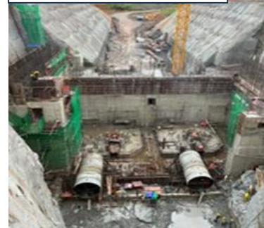
発電機設置場所
